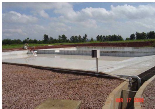
Figura 5 – Direcionamento da água da chuva para as piscinas Fonte: Empresa Mineradora (2009)
